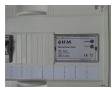
Power m/backup uPU: montert i el-skap eller påvegg
